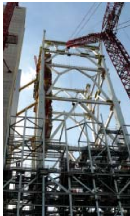
Ocelová konstrukce kotle
